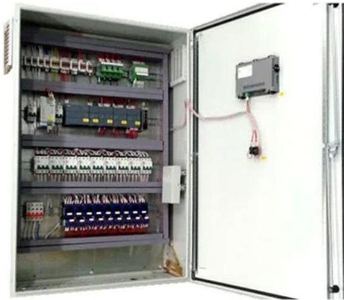
Рис.1. Шкаф контролируемого пункта КП.
